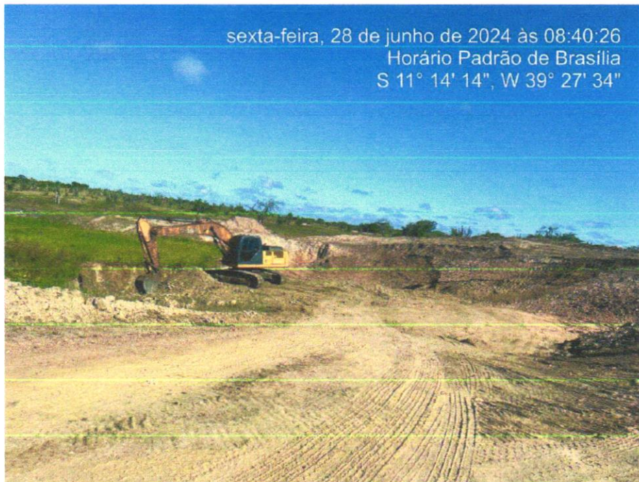
Foto 03 - ESCAVACAO E CARGA MATERIAL 1A CATEGORIA, UTILIZANDO TRATOR DE ESTEIRAS DE 110 A 160HP COM LAMINA, PESO OPERACIONAL * 13T E PA CARREGADEIRA COM 170 HP.
